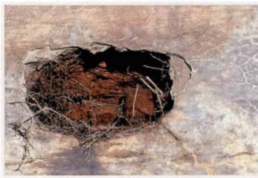
OQUEDAD EN MURO DE CISTERNA POR RAÍCES Y FALTA DE MANTENIMIENTO
