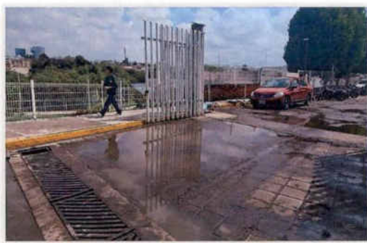
FALTA DE SISTEMA DE DESALOJO DE AGUA PLUVIAL
