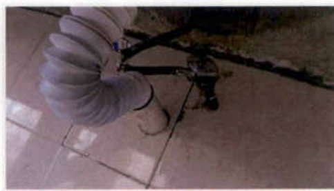
ACCESORIOS SANITARIOS DAÑADOS
