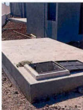
Cuenta con sistema pluvial que llega a una cisterna 20 m 3
