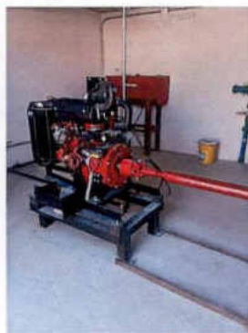
Sistema y cisterna PCI (Protección Contra Incendios) 58 M 3 , sin conexión a la red
