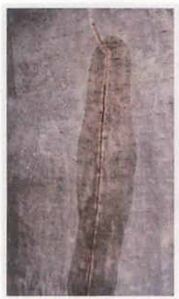
FALLA ESTRUCTURAL EN MUROS DE CISTERNA
